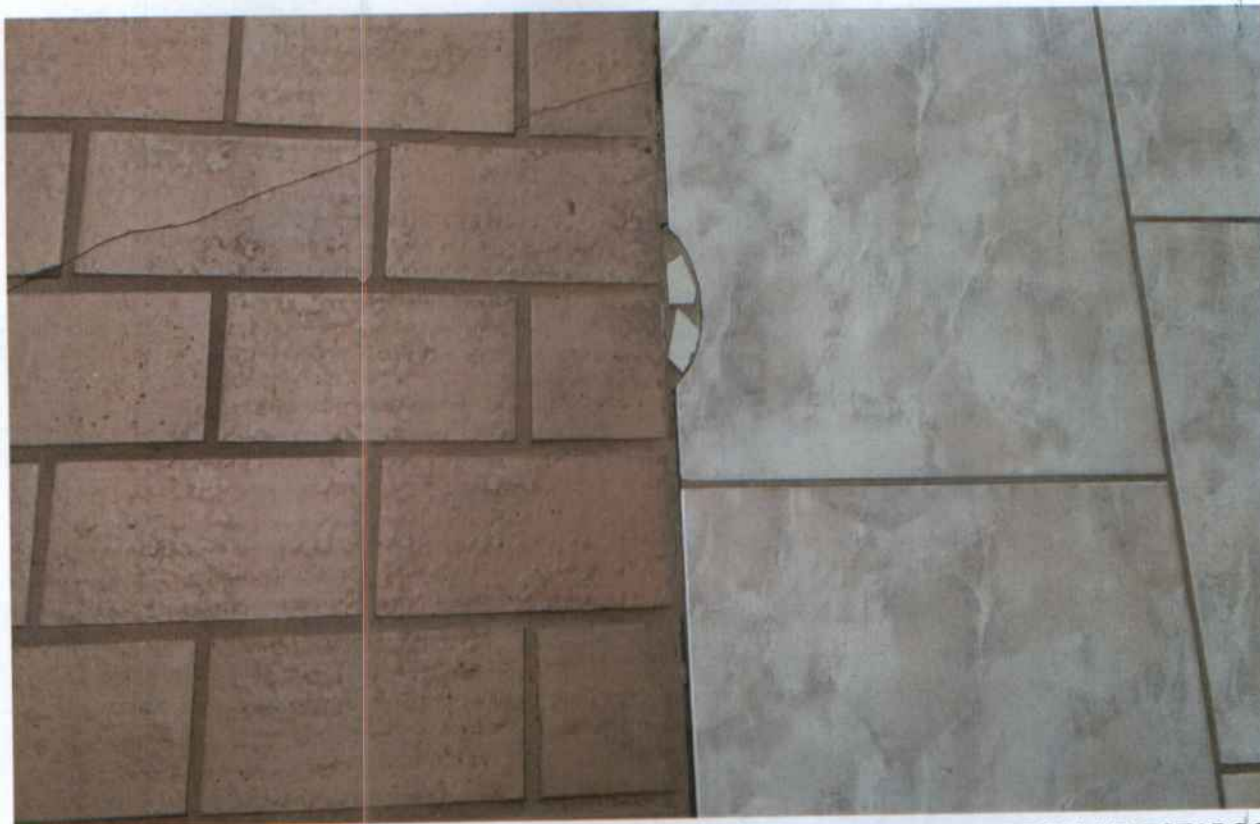
(FOTO 08 – MOSTRA PARTE DO PISO DA VARANDA E ÁREA EXTERNA: EM REGULAR ESTADOO DE CONSERVAÇÃO)
