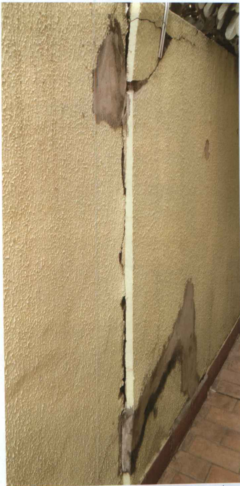
(FOTO 05 - MOSTRA PARTE DO MURO LATERAL DO IMÓVEL: EM RUIM ESTADO DE CONSERVAÇÃO)
